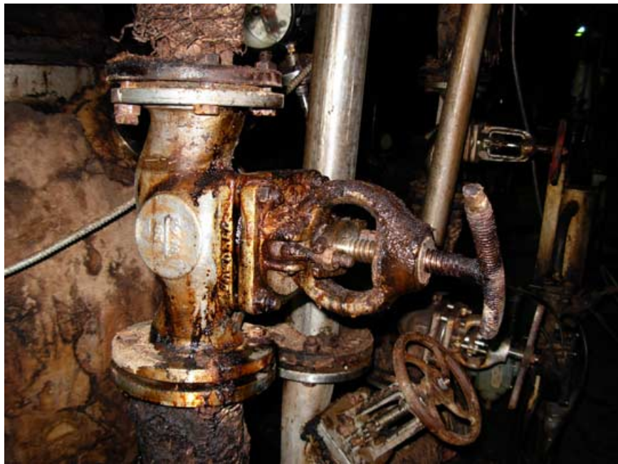
Трубы, по которым щелочь идет в варочные котлы.
