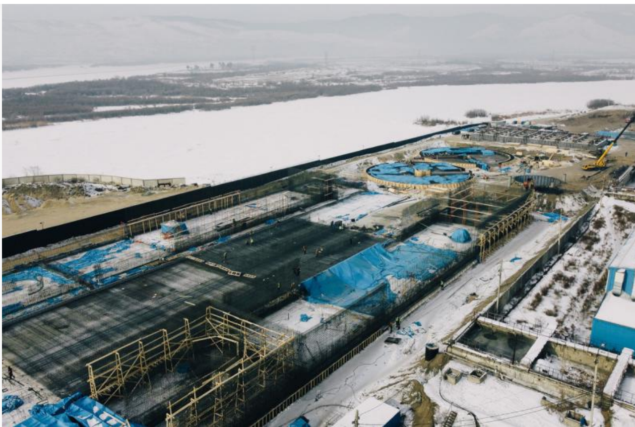
Очистные в Улан-Удэ
