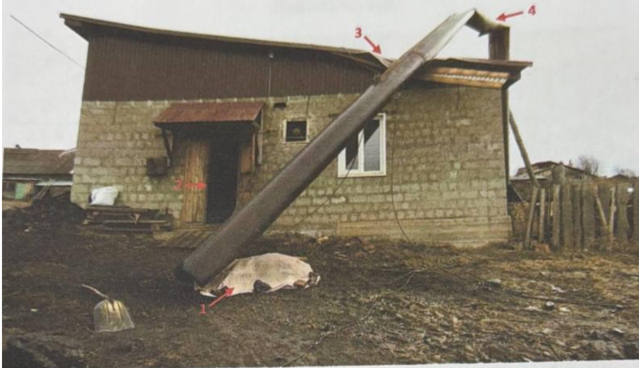
Фото №4. Здание котельной с упавшей трубой и окружающая территория. Вид в юго-восточном направлении.
