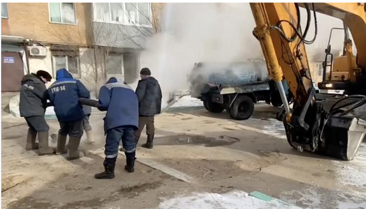
Прорыв трубы на улице Калашникова в феврале 2025 года закончился тем, что жилой дом подтопило, а от пара пострадало несколько квартир
