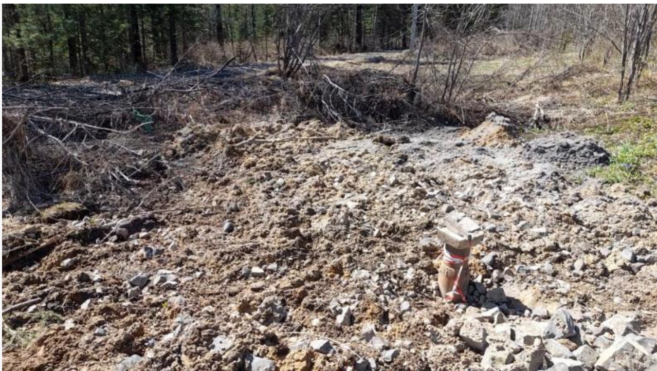
Скважина пробурена, но не подключена
