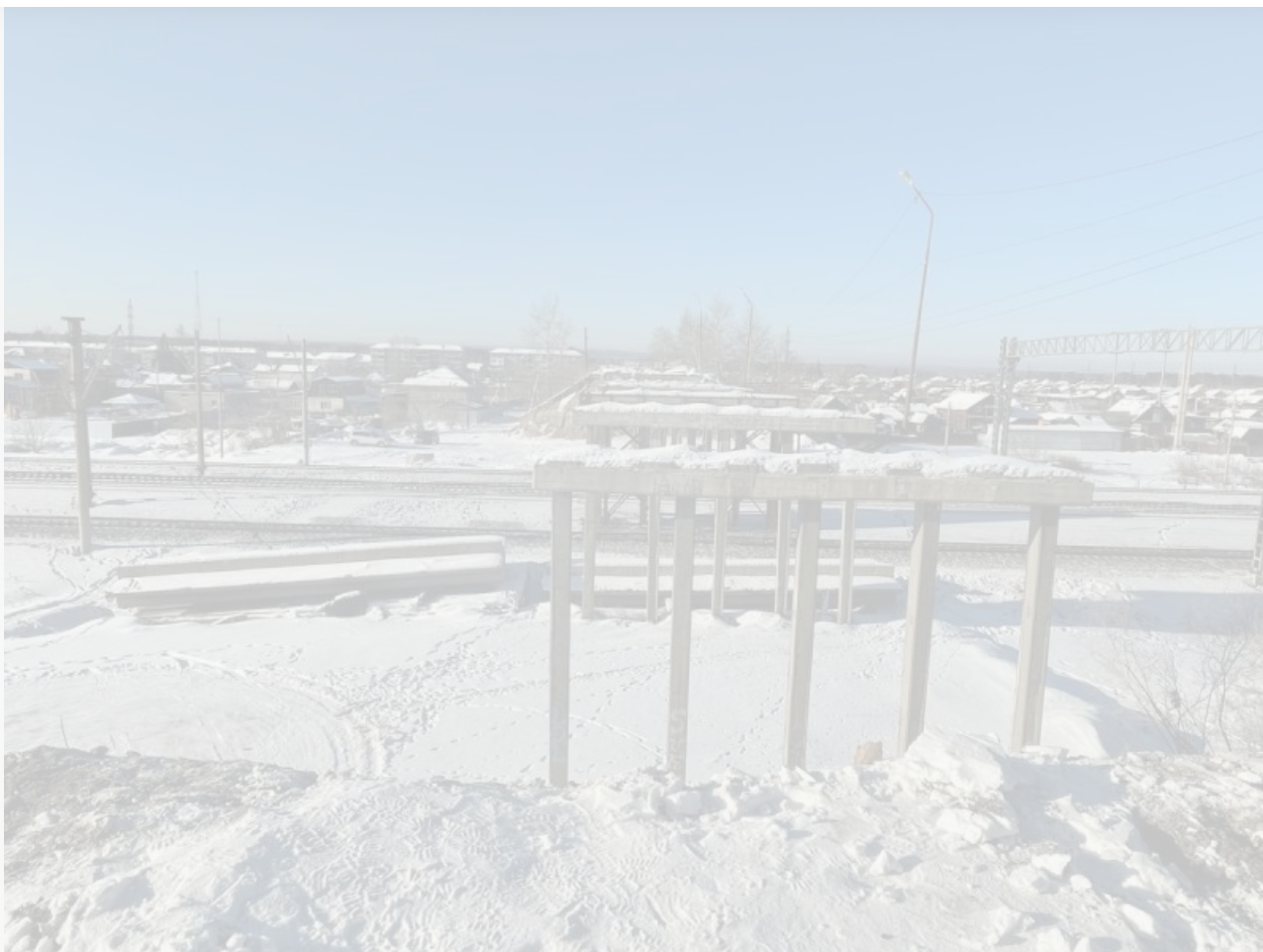
Тот самый разрушенный виадук в Мегете
