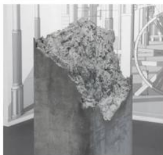
Референс: Сколотый край бетонного блока
