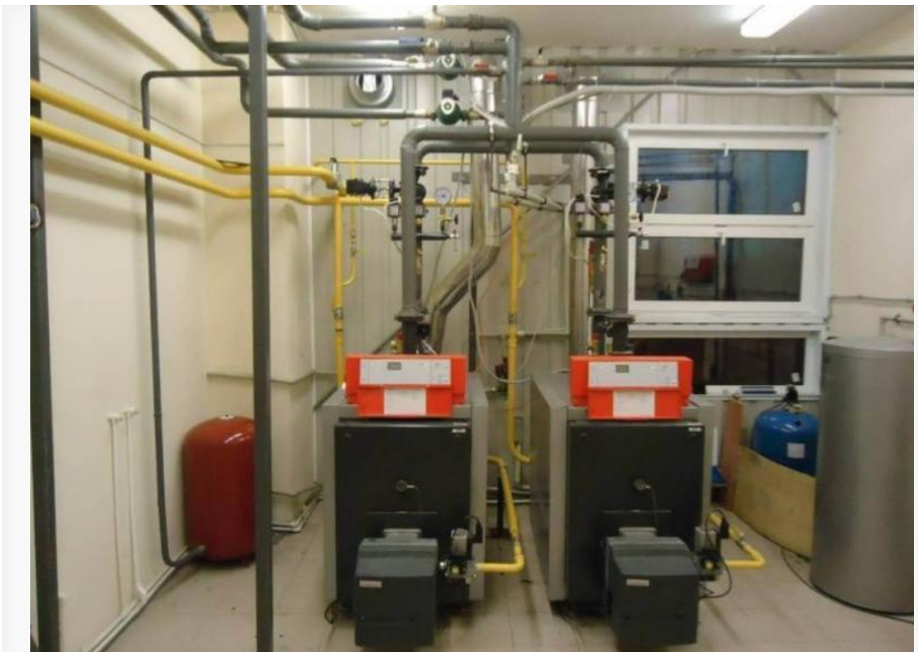
Комбинированный котёл отопления
