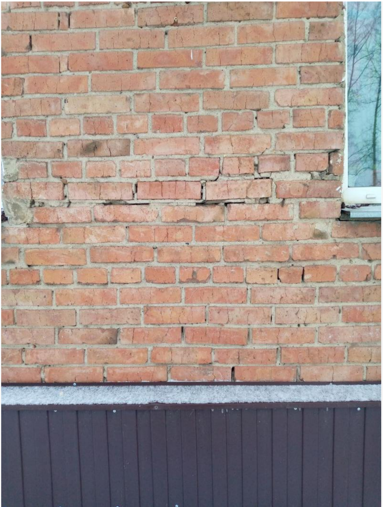
Свежие трещины и разрывы. Дом рвёт от наклона
