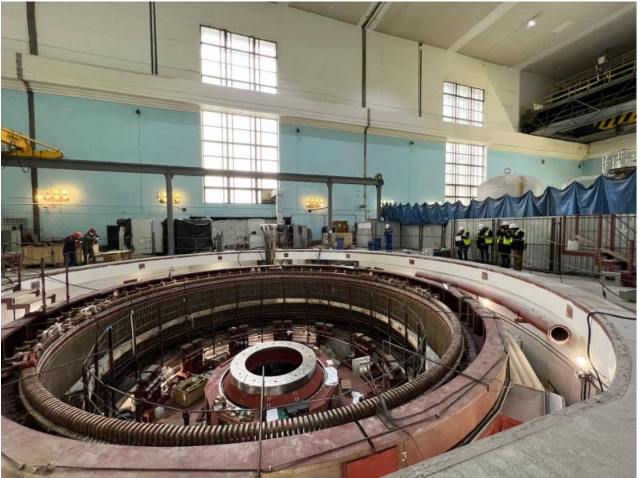
Там идут масштабные работы по замене гидроагрегата, недавно закончен ремонт дороги на плотине. Репортеры побывали на экскурсии в машинном зале ГЭС.
