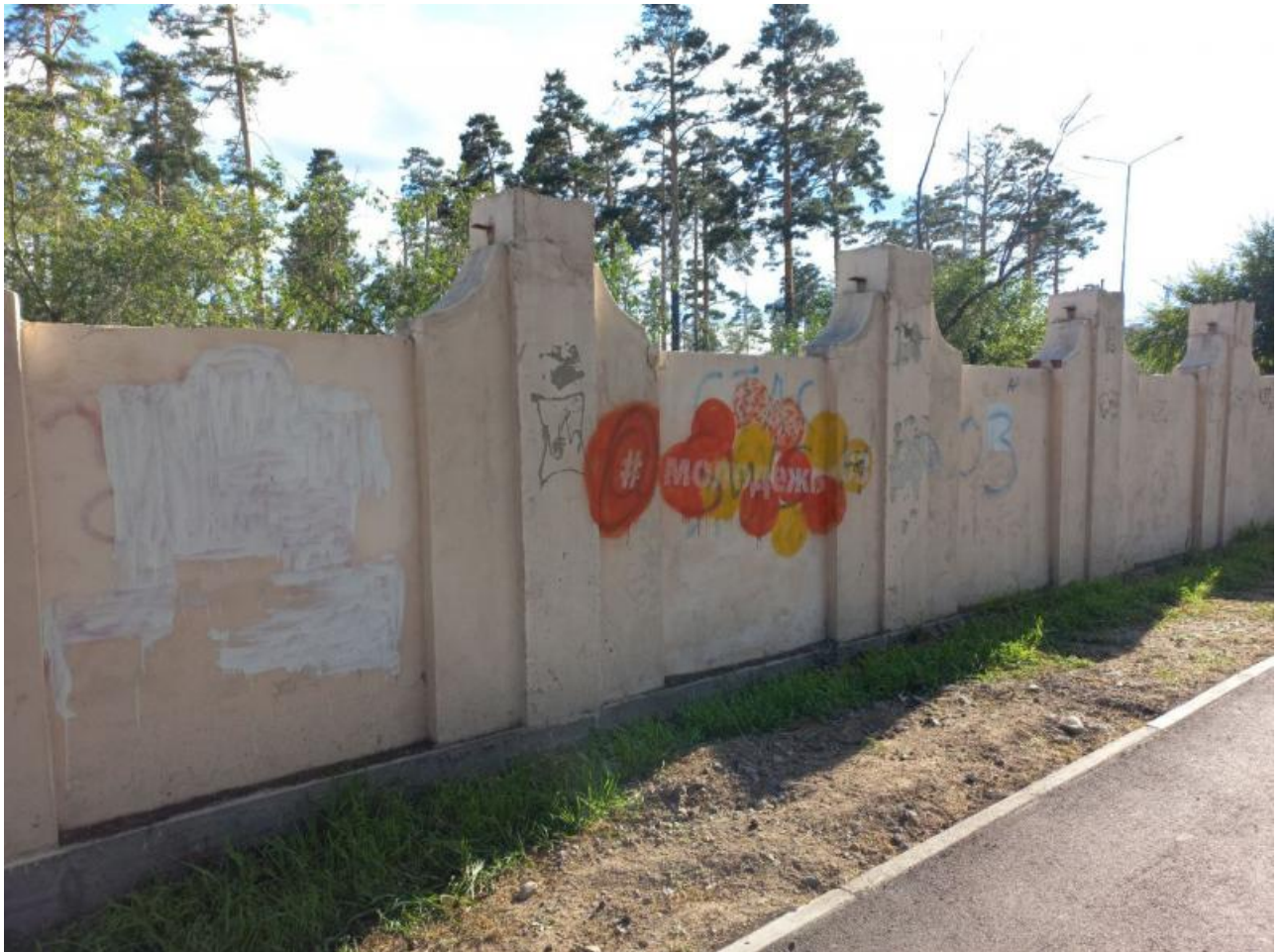
Дыры в ограждении залатали профнастилом. Экономно.
