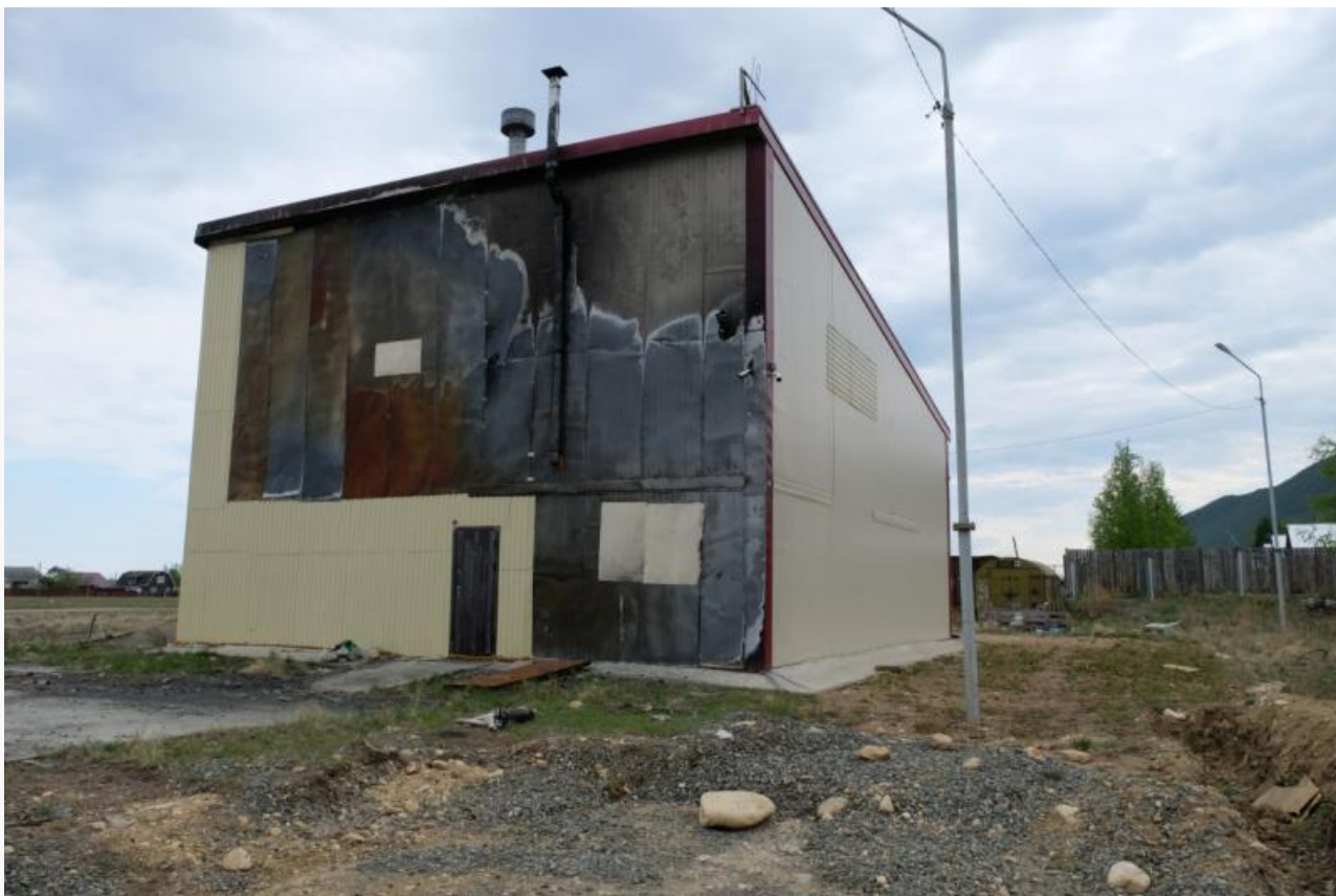
Так выглядело здание очистных спустя два года после ЧП (фото от 9 июня 2021 года).
