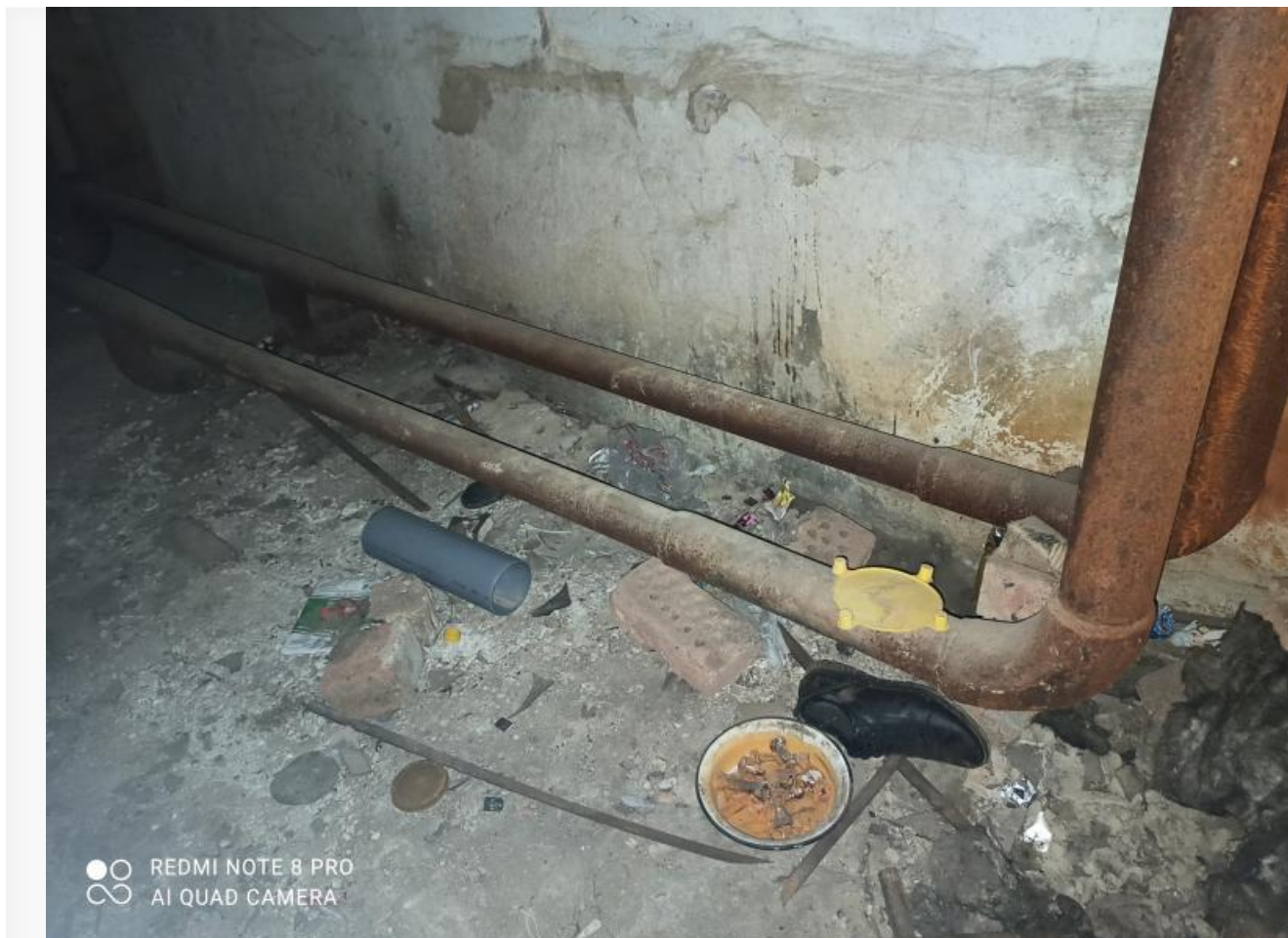
Бабушкина 98б. Мусор, отсутствие окраски и изоляции.
