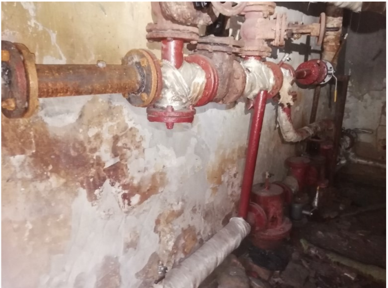
Анохина, 67. Отсутствие изоляции теплового узла и контрольно- измерительных приборов.
