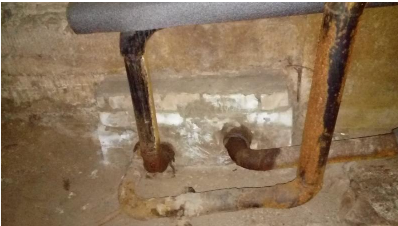
Гагина, 11. Отсутствие теплоизоляции, нарушения СНИПов
