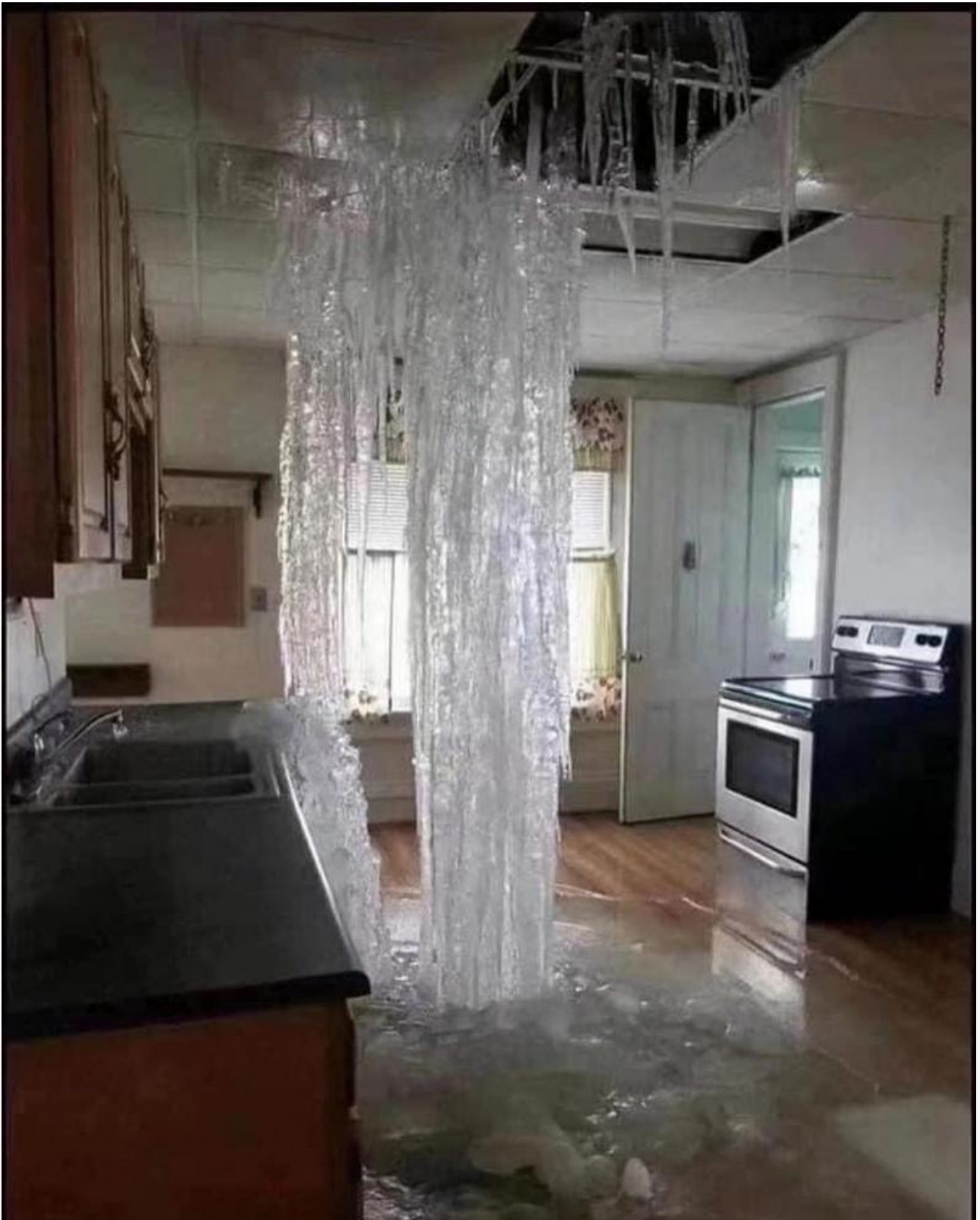
Трубы не выдерживают в домах...
