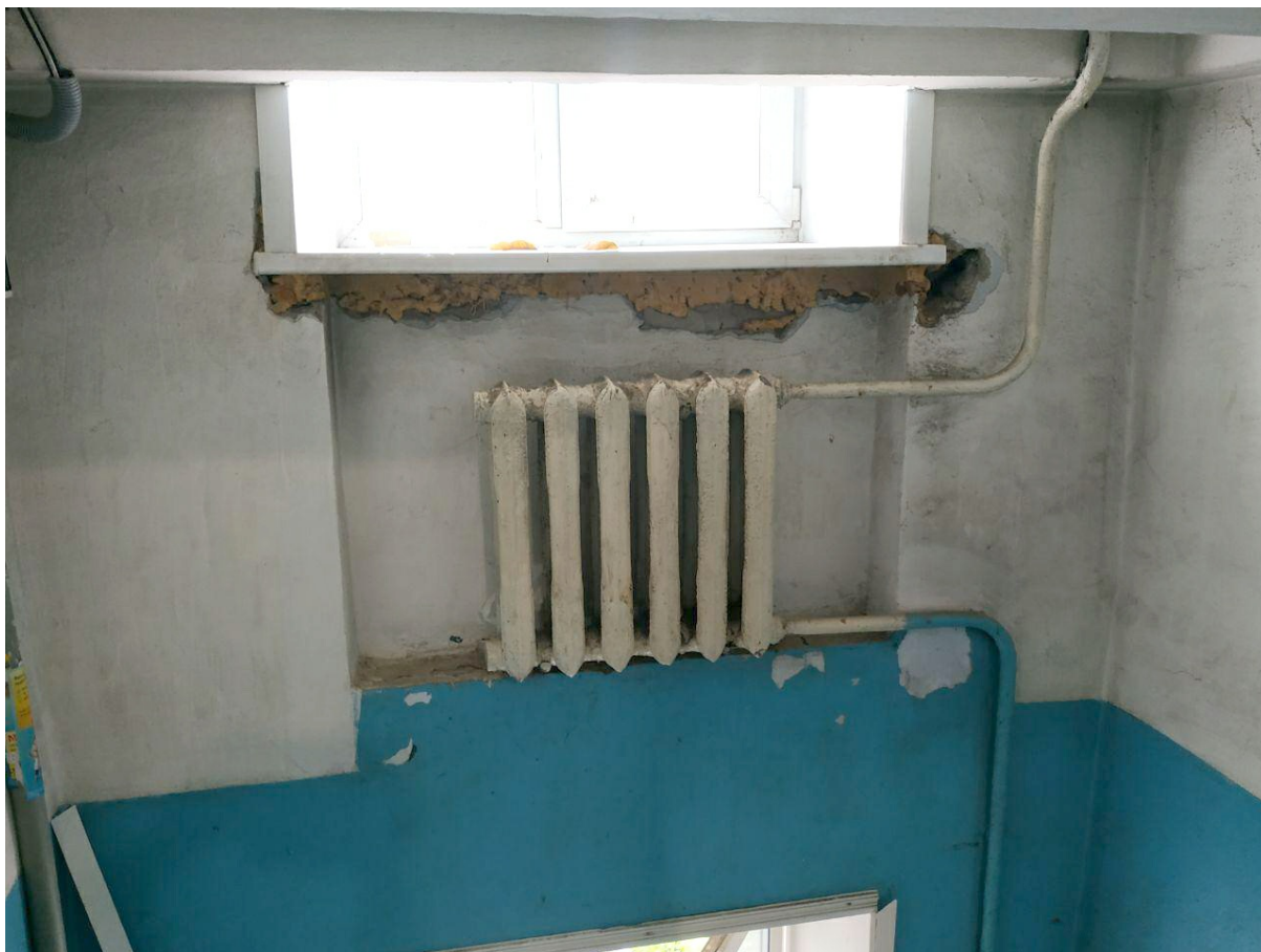
Батареи не менялись с постройки дома.
