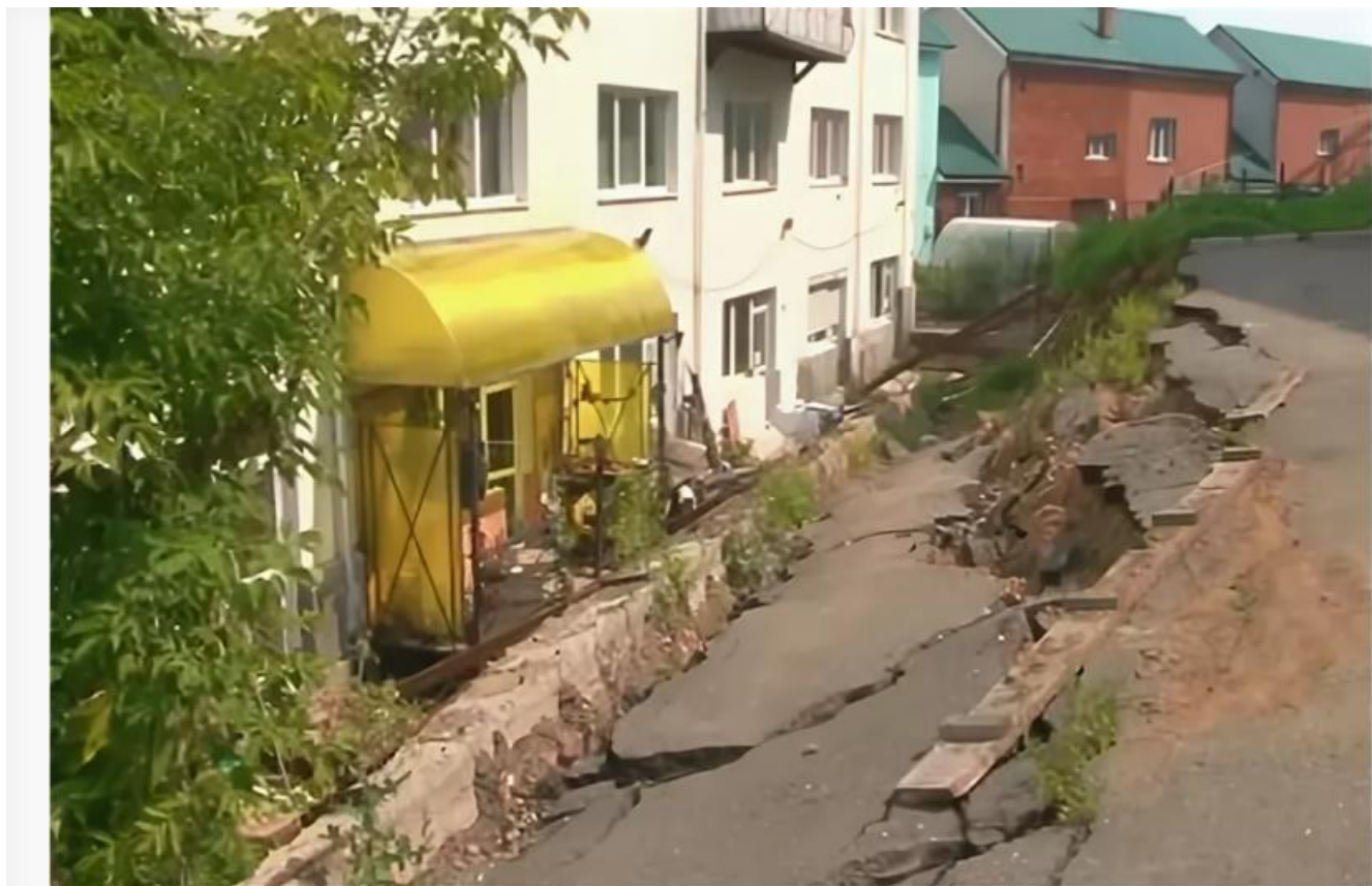
Обвал опорной стены в 2016 году
