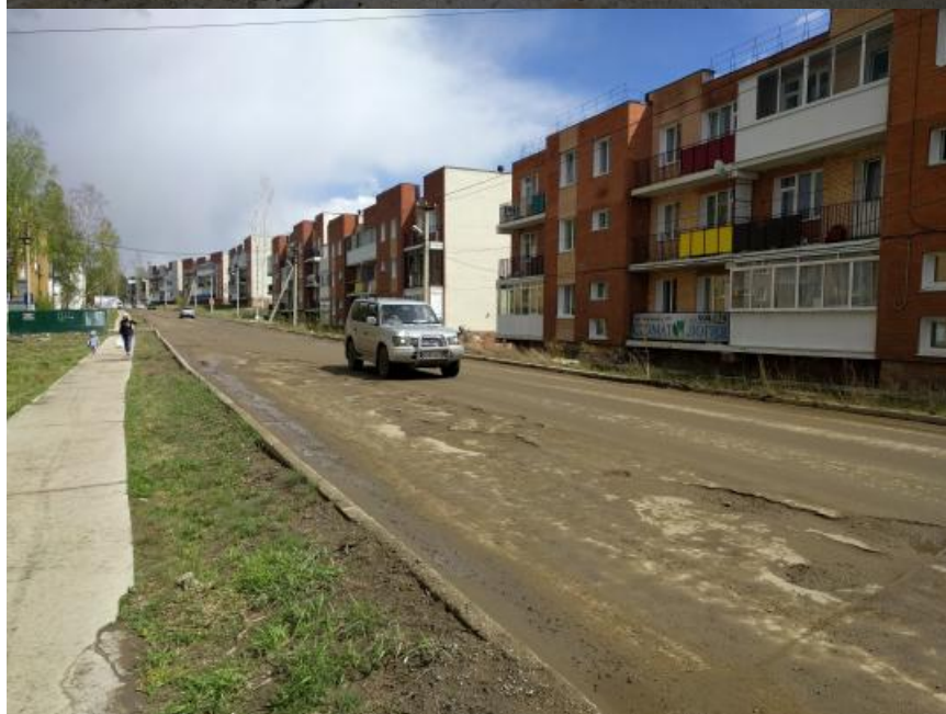
По итогам последней зимы дорога в "Березовом" пришла в полную негодность. Асфальт и бетон сошли вместо со снегом. Яма на яме.
