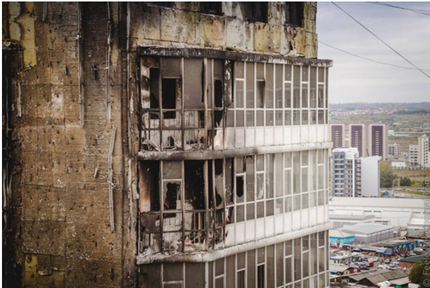
5. Пламя охватило здание за считанные минуты, горел весь фасад с 1-го по 25-этаж.
