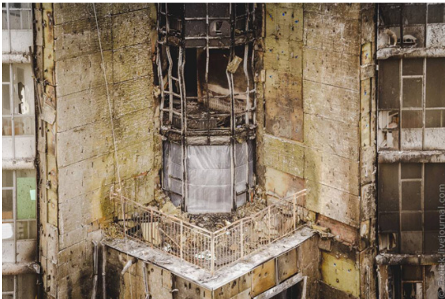
6. Тушение осложнялось тем, что снаружи потушить его было очень непросто. Горели композитные панели изнутри благодаря тому, что между стеной и фасадом свободно гуляет воздух.
