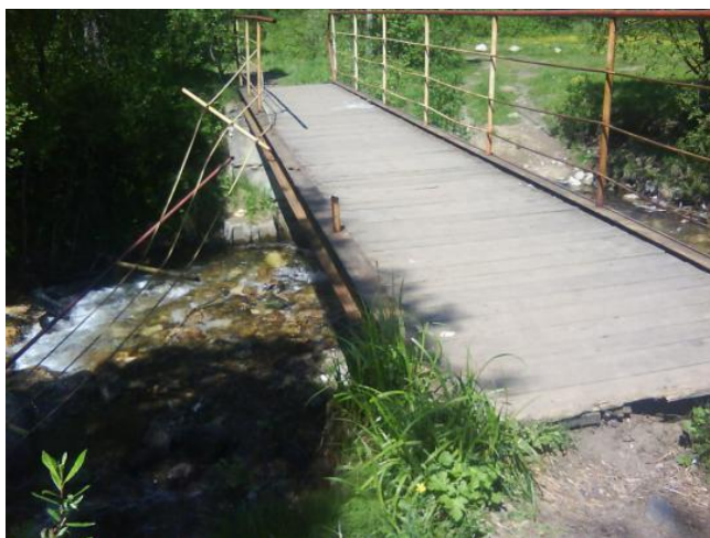
Пешеходный мостик через р. Харлахту. Недолго простоял в нормальном состоянии.
