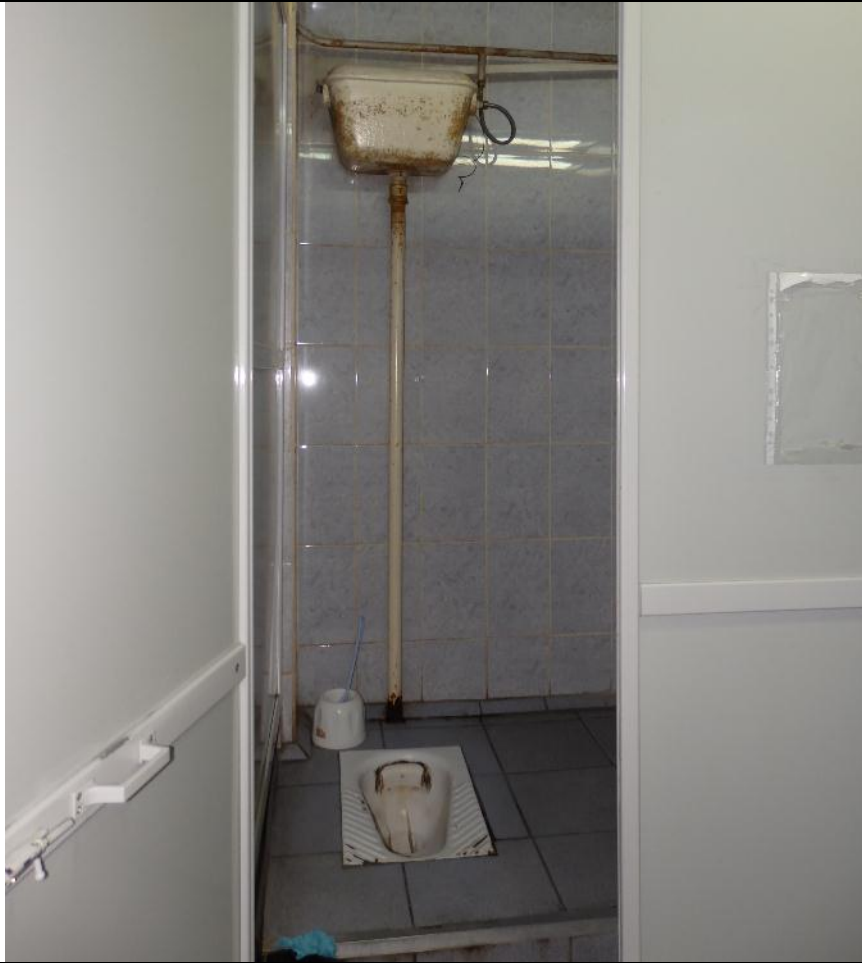
фото 48. Состояние приборов инженерных коммуникаций. Отмечены следы коррозии, окрасочный слой нарушен.
