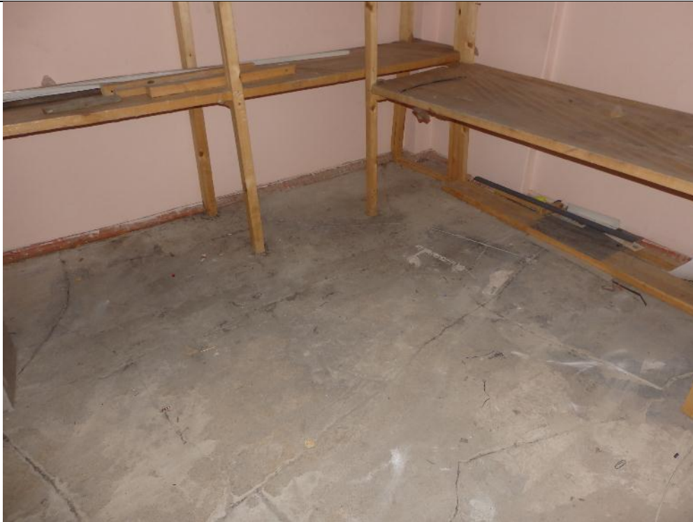
фото 41. На бетонной стяжке пола в помещении 5-го этажа зафиксированы трещины, шириной раскрытия до 3 мм.
