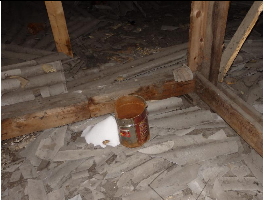
фото 23. На перекрытии 5-го этажа в помещении чердака зафиксирован снег, в результате нарушения кровельного покрытия.
