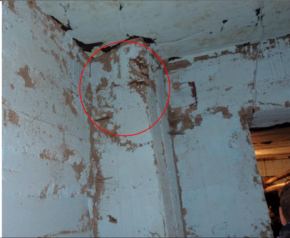
фото 59. Зафиксированы участки нарушения защитного слоя бетона колонн подвала в осях 5/В, оголенная арматура поражена коррозией металла.
