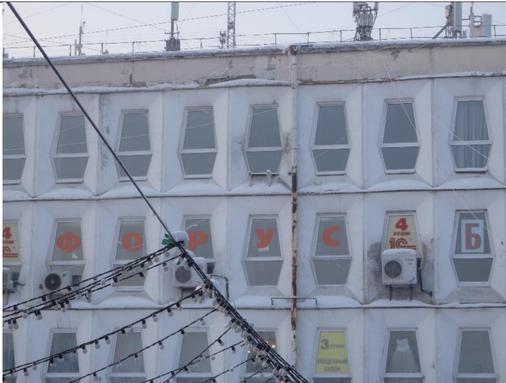
фото 3. Фрагмент фасада в осях 4-6/А. На верхней части здания отмечены участки нарушения отделочного слоя (отслоение штукатурного и окрасочного слоев).
