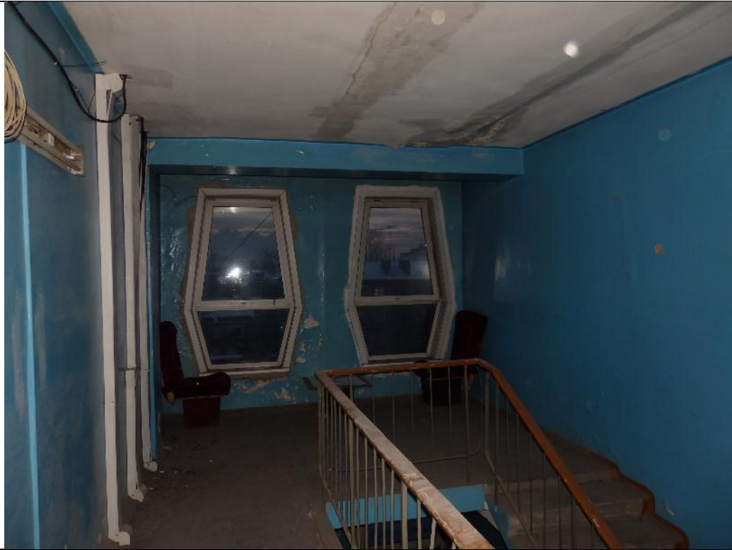
фото 35. На потолочной поверхности перекрытий 5-го этажа, в помещении лестничной клетки в осях 3-4/Д-Е зафиксированы следы увлажнения, отделочный слой поврежден.
