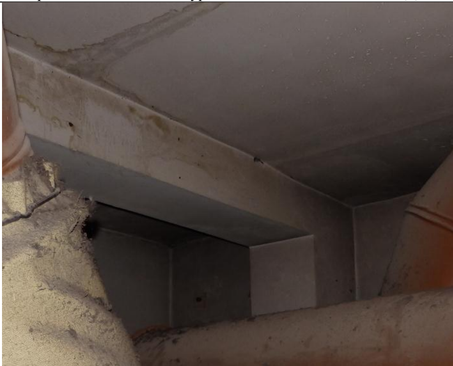
фото 28. На потолочной поверхности перекрытия вент.камеры, расположенной выше уровня 5-го этажа отмечены следы протечек, отделочный слой поврежден.
