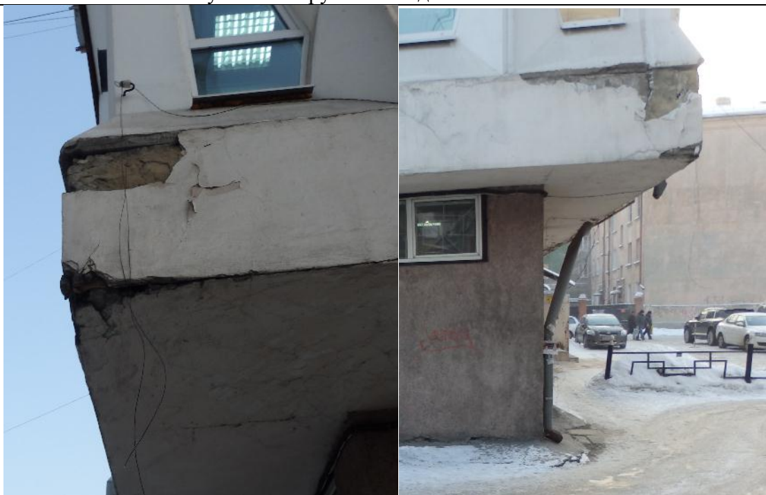
фото 10. Состояние консоли 1-го этажа здания на углу в осях 8/Е. Зафиксировано разрушение штукатурного слоя металлических конструкций доборных частей стенового ограждения, следы поверхностной коррозии.
