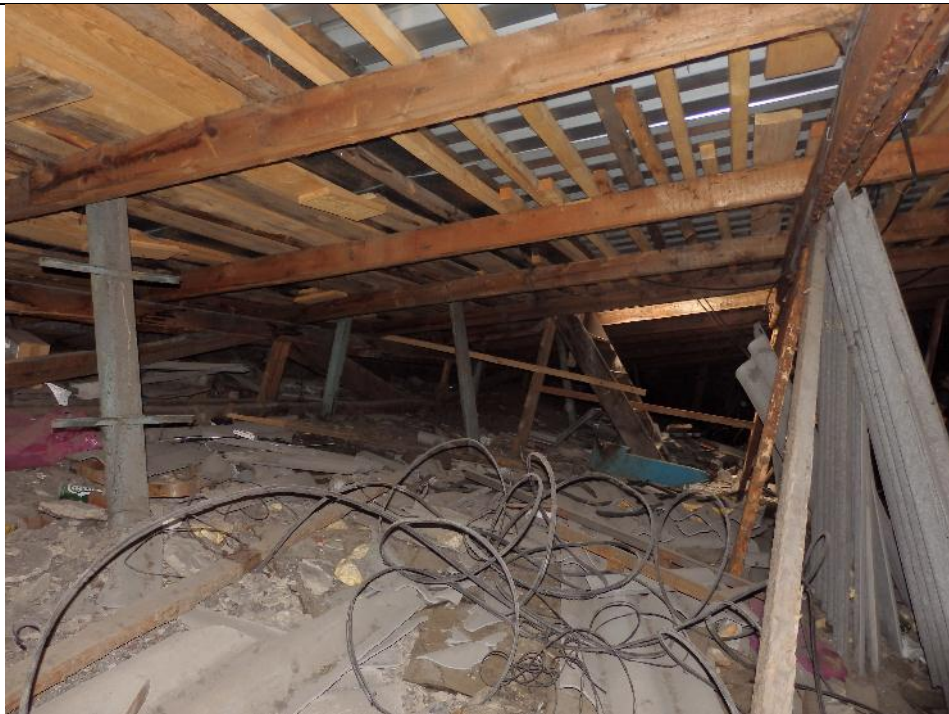
фото 18. Шаг обрешетки неравномерный. Часть стоек стропильной системы опирается точечно на плиты перекрытия 5-го этажа, вертикальность стоек нарушена.
