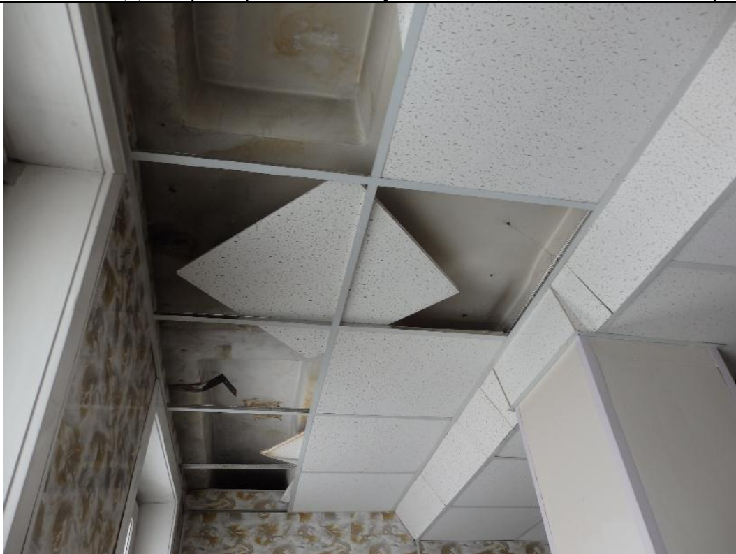
фото 36. На потолочной поверхности перекрытия 5-го этажа (монолитный участок консоли) в помещении №53(согласно спецификации помещений) зафиксированы следы увлажнения, отделочный слой поврежден.
