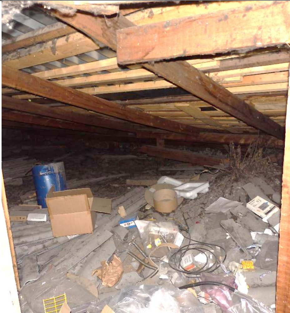
фото 19. Чердачное помещение захламлено строительным мусором.
