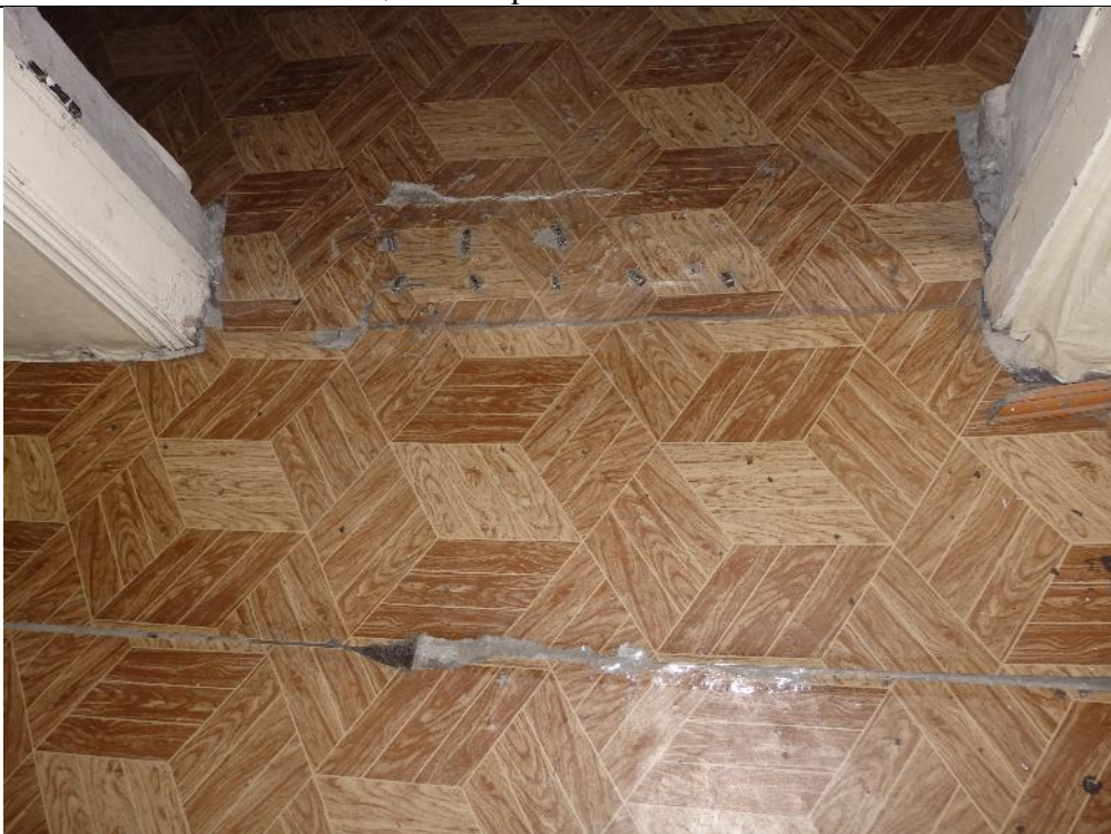
фото 46. Отмечены участки нарушения линолеумного покрытия полов (разрывы, неровности, стертости).
