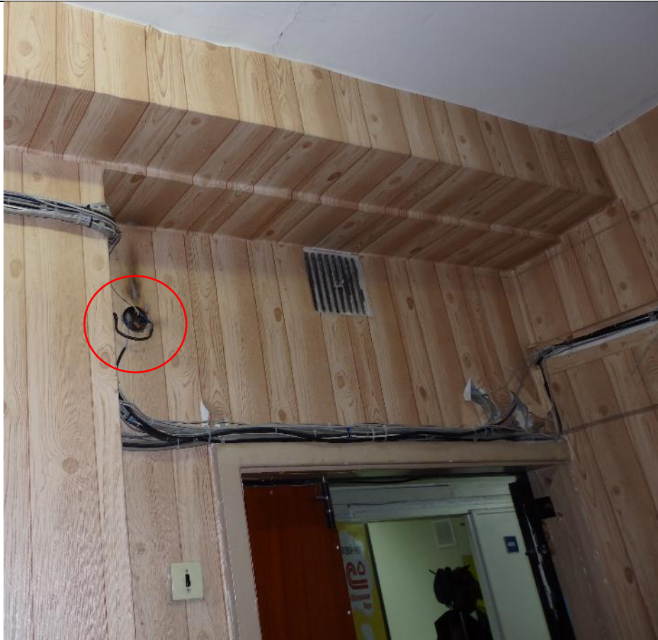
фото 45. Зафиксированы следы горения электропроводки в распределительной коробке. Вентиляционные решетки забиты пылью.
