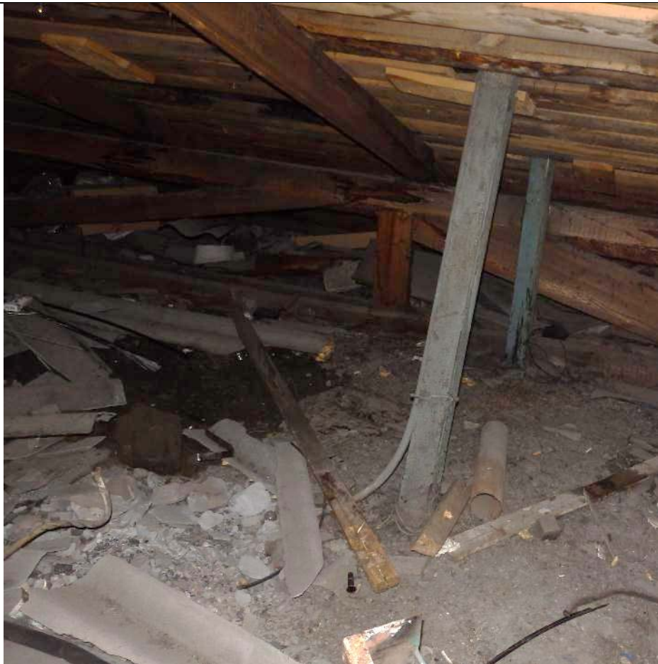
фото 17. На перекрытии 5-го этажа зафиксированы следы протечек кровли, в результате чего происходит увлажнение элементов стропильной конструкции. Чердачное помещение захламлено.
