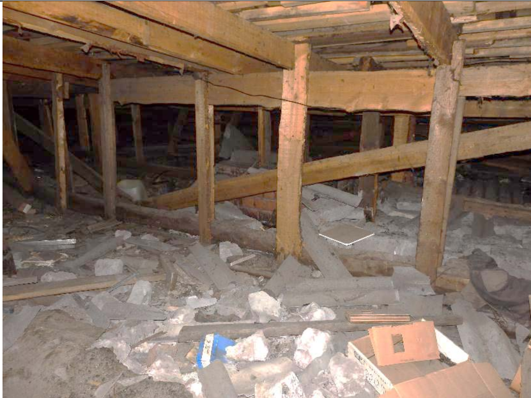
фото 20. Чердачное помещение захламлено строительным мусором.
