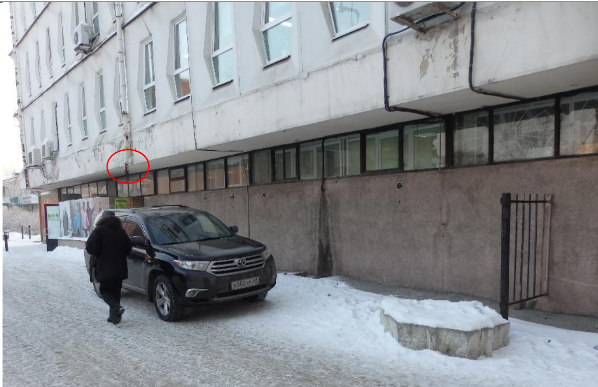
фото 13. Состояние 1-го этажа фасада в осях А-Е/8. Отделочный слой местами поврежден, зафиксировано нарушение труб водосточной системы.
