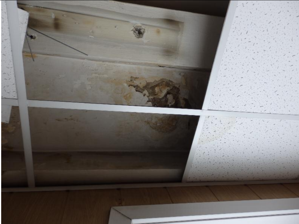
фото 38. На потолочной поверхности перекрытия 5-го этажа (монолитный участок консоли) в помещении №61(согласно спецификации помещений) зафиксированы следы увлажнения, отделочный слой поврежден.
