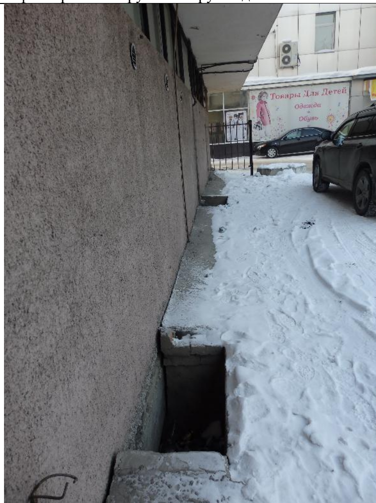
фото 14. На перилках, расположенных вдоль фасада в осях А-Е/8 отсутствуют оградительные решетки, перилки захламлены мусором.
