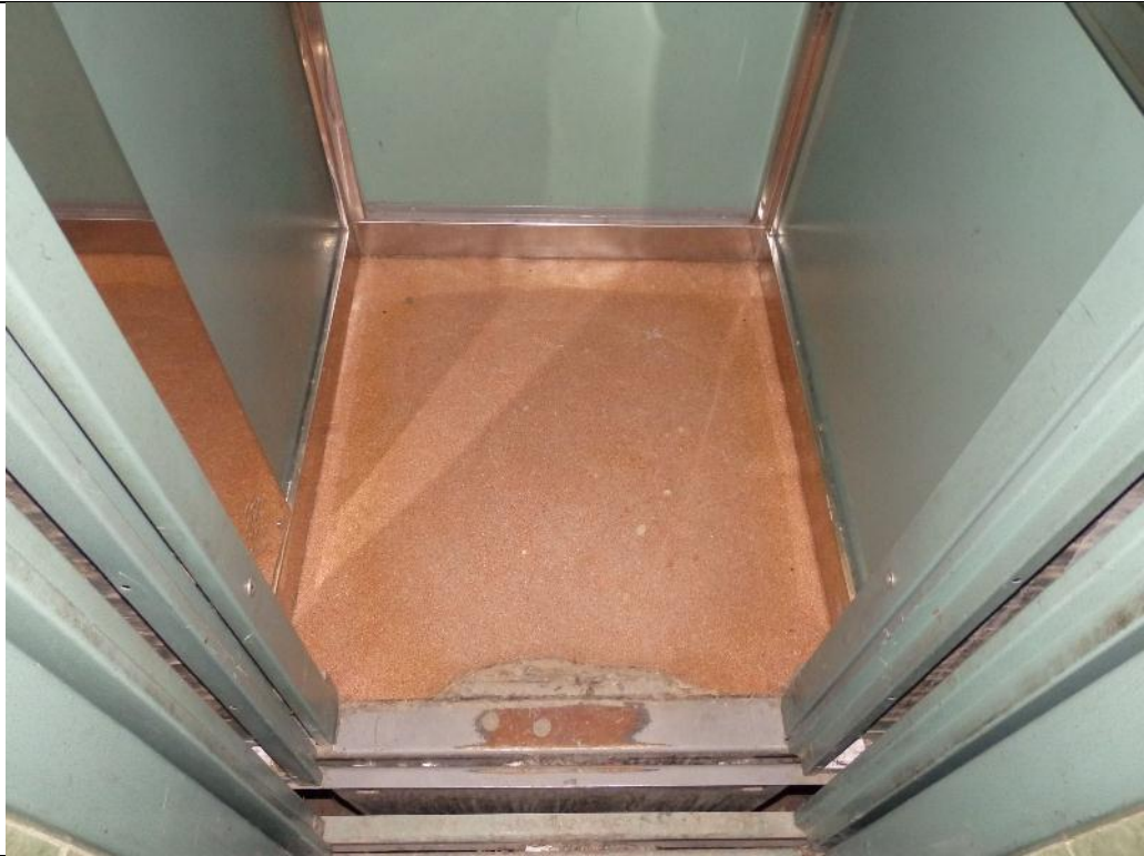
фото 55. Состояние пассажирского лифта, расположенного в осях 3-4/Г-Д.
