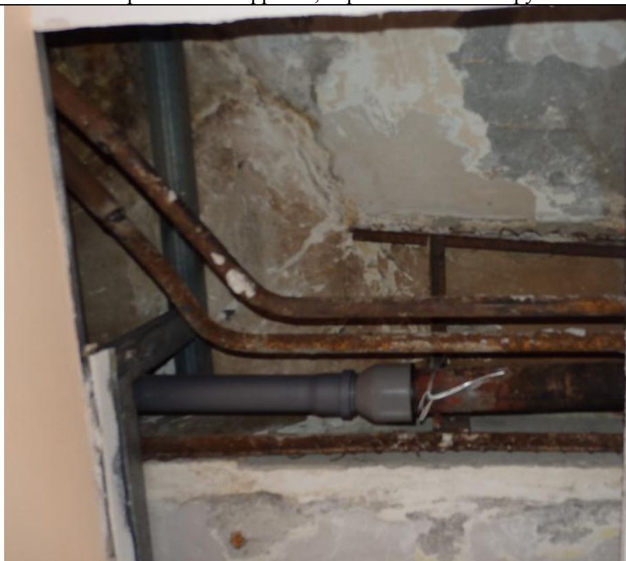
фото 50. Трубы водопровода и канализации, проходящие под потолком 2-го этажа в помещении № 40 (согласно экспликации помещений) в значительной степени поражены коррозией металла, окрасочный слой полностью отсутствует.
