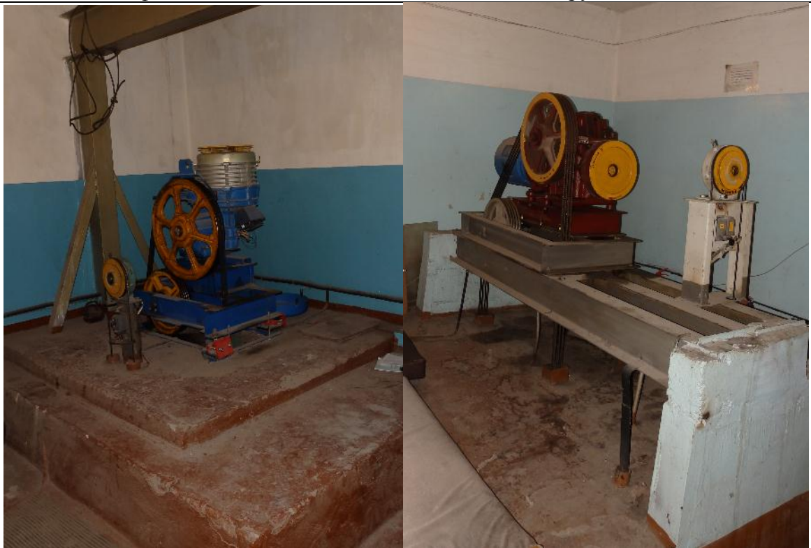
фото 30. Состояние оборудования грузового и пассажирского лифтов.
