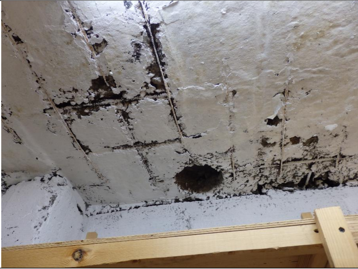
фото 57. На потолочной поверхности монолитного перекрытия подвала в осях 2/Д отмечены участки нарушения защитного слоя бетона, оголенная арматура поражена поверхностной коррозией металла.
