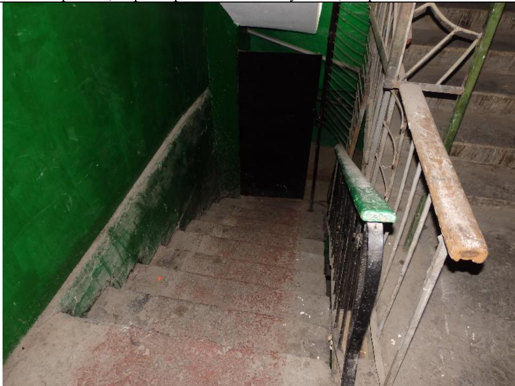
фото 32. На лестничном марше, ведущем с 1-го этажа в подвал, междуэтажной лестницы в осях 3-4/Д-Е, зафиксированы сколы ступеней, стертости в ходовых местах.
