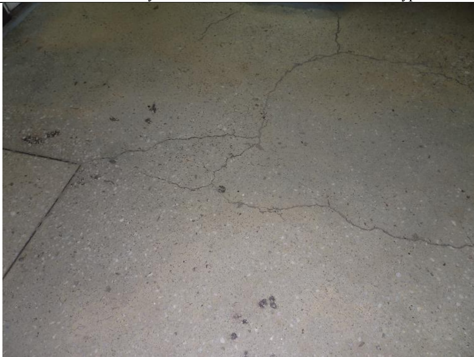
фото 52. На бетонных полах здания в коридорах и вестибюлях зафиксированы трещины различного направления и протяженностью, шириной раскрытия до 2 мм.
