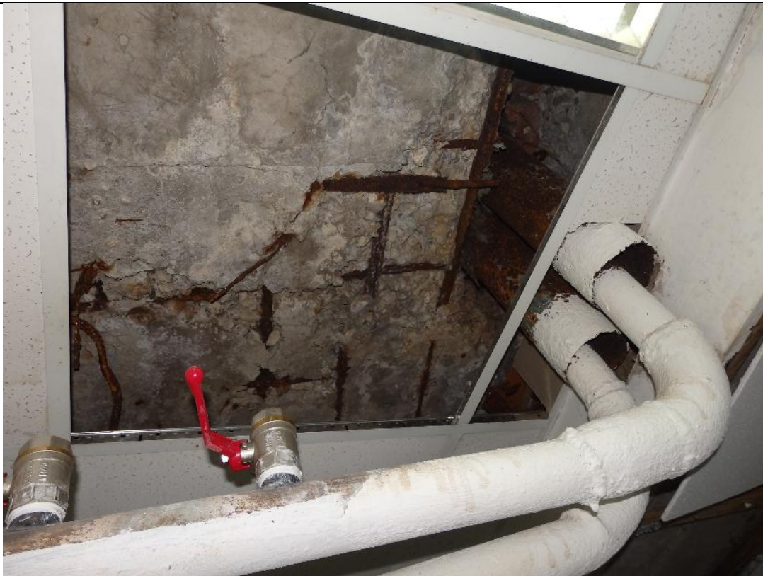
фото 61. На потолочной поверхности монолитного перекрытия подвала в местах прохождения инженерных стояков отмечены участки нарушения защитного слоя бетона, оголенная арматура поражена поверхностной коррозией металла (у колонны в осях 6/Е, помещение санузла).
