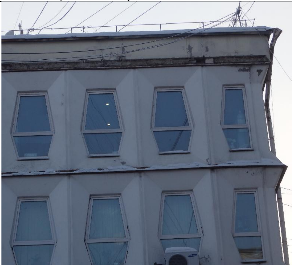
фото 12. Фрагмент фасада здания в осях Д-Е/8. Отмечено нарушение защитного слоя штукатурки арматурной сетки консоли в верхней части здания.
