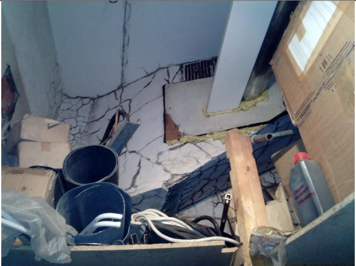
фото 53. Зафиксированы значительные нарушения отделочного слоя вент.короба и перегородок в помещении №31 первого этажа (согласно экспликации помещений).
