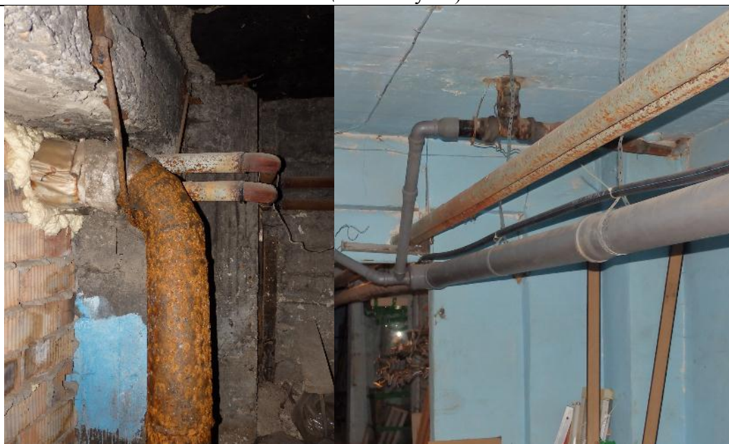
фото 62. Состояние труб инженерных коммуникаций в подвале. Зафиксированы участки значительного поражения металлических труб коррозией, окрасочный слой поврежден, местами полностью отсутствует.
