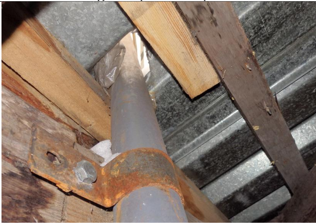
фото 24. Отмечены сквозные отверстия в кровле в местах установки антенн.
