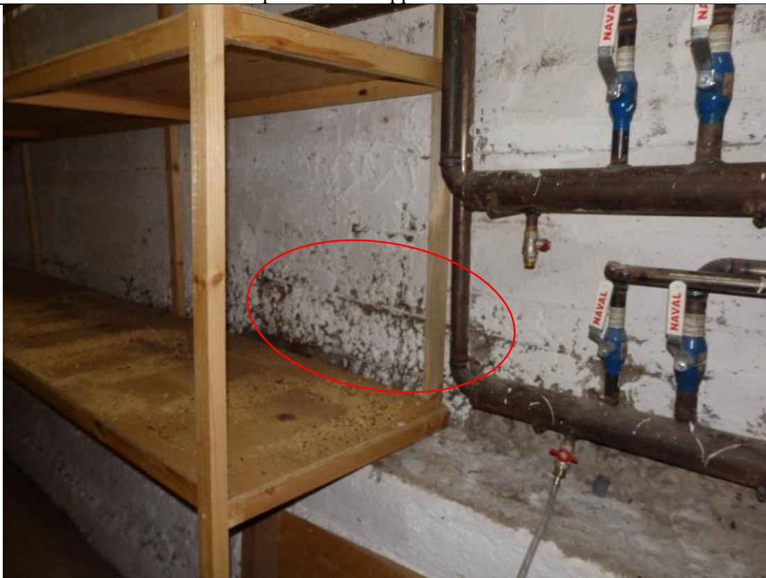
фото 58. На поверхности внутренних монолитных стен подвала в осях 2-1/Д отмечены участки нарушения защитного слоя бетона, оголенная арматура поражена поверхностной коррозией металла.
