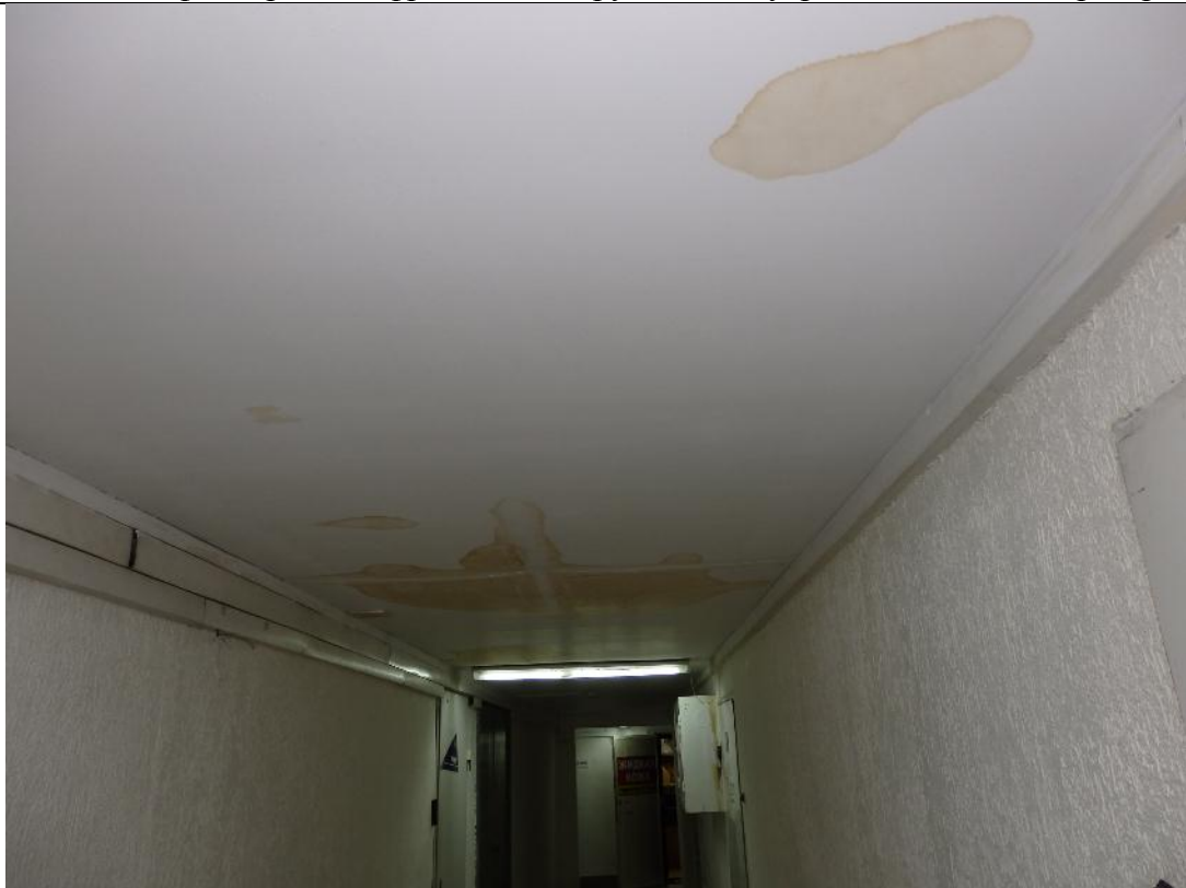
фото 44. На потолочной поверхности перекрытия 4-го этажа в помещении коридора № 63 (согласно экспликации помещений) отмечены следы увлажнения.
