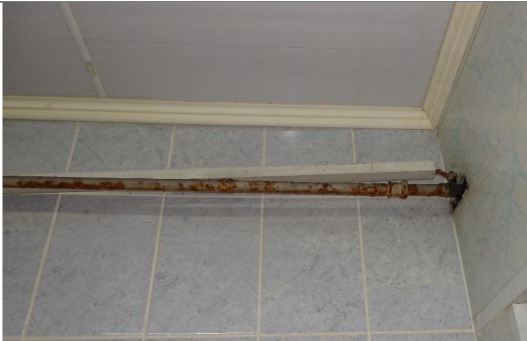
фото 49. Состояние труб системы водопровода в санузле 3-го этажа. Отмечена поверхностная коррозия, окрасочный слой нарушен.
