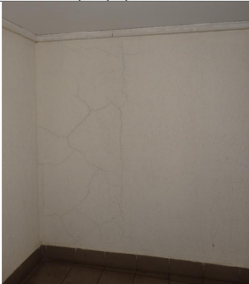
фото 42. По отделочному слою перегородки 4-го этажа в осях Г-Д/6 отмечены волосяные трещины.
