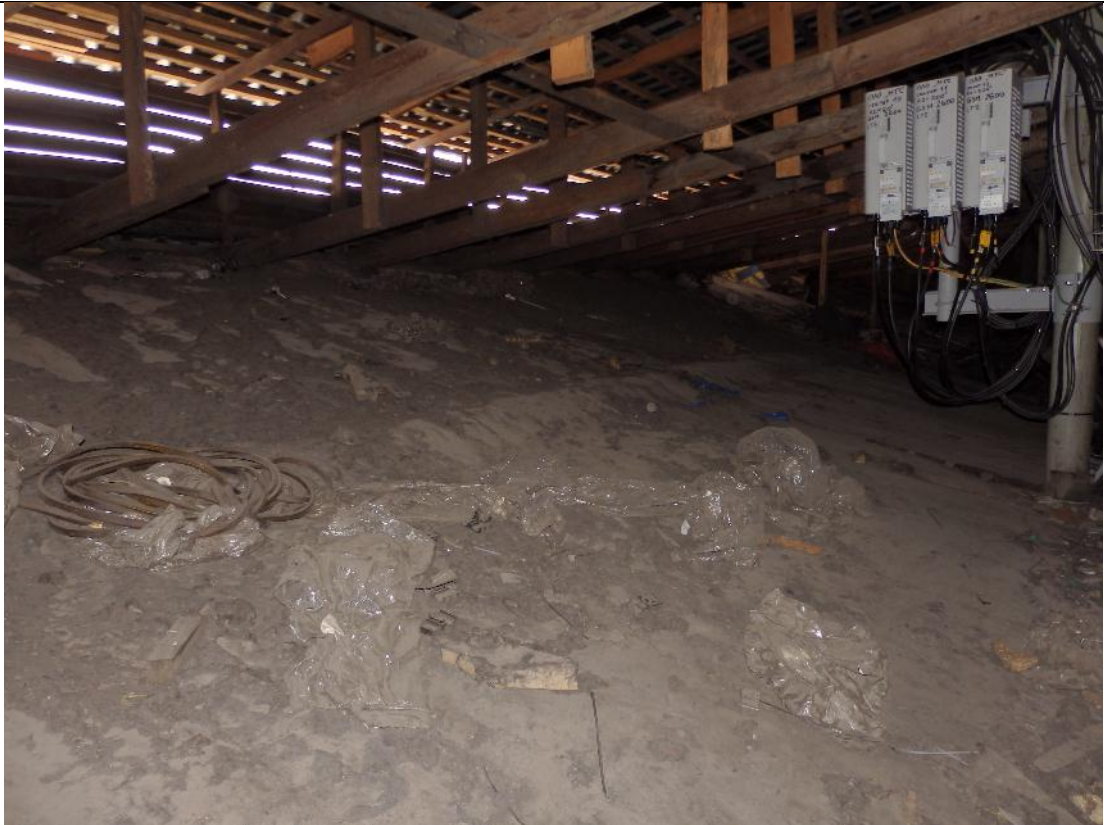
фото 25. Состояние подкровельного пространства вентиляционной камеры.
