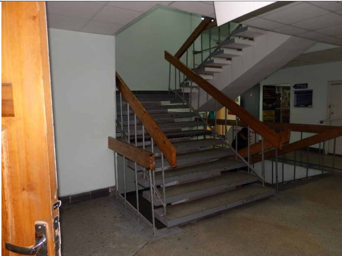
фото 51. Состояние междуэтажной лестницы в осях 3-4/Б-В на уровне 2-го этажа.
