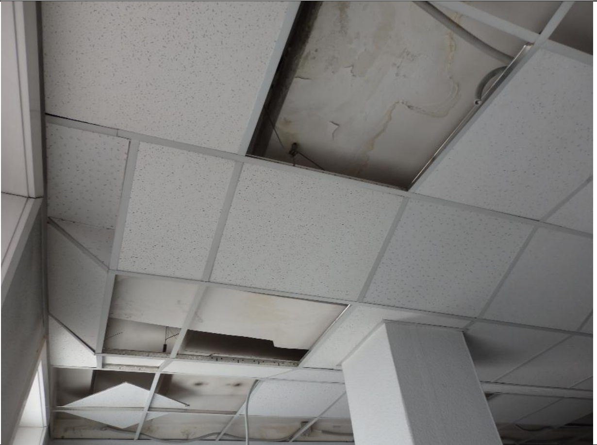
фото 37. На потолочной поверхности перекрытия 5-го этажа (монолитный участок консоли) в помещении №25 (согласно спецификации помещений) зафиксированы следы увлажнения, отделочный слой поврежден.
