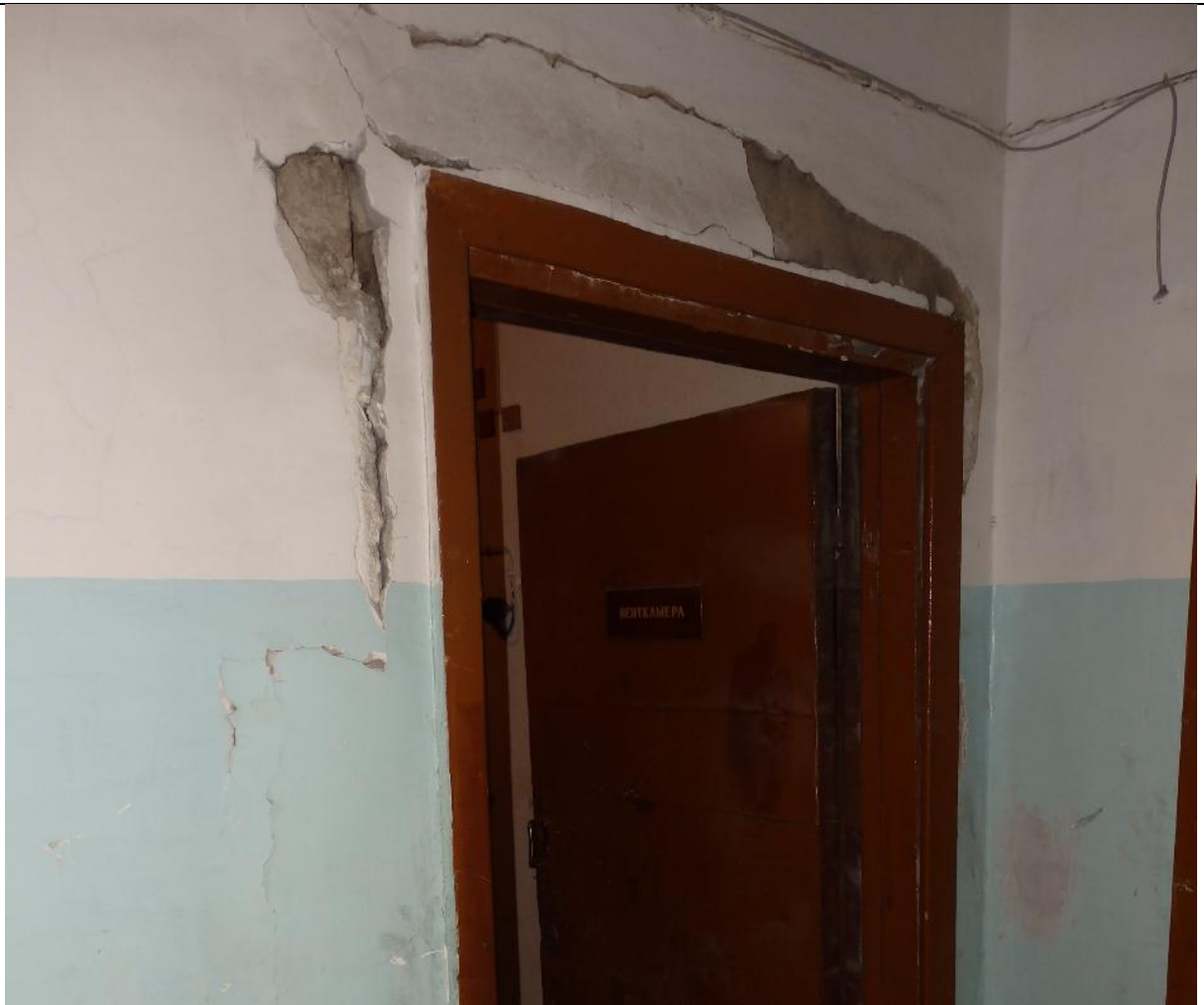
фото 27. Зафиксированы участки нарушения отделочного слоя перегородок вент.камеры, расположенной выше уровня 5-го этажа в осях 3-б/В-Д.
