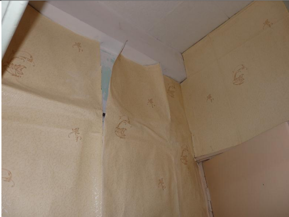
фото 43. Зафиксированы фрагменты нарушения внутренней отделки перегородок.
