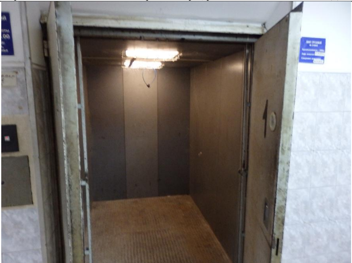
фото 56. Состояние грузового лифта, расположенного в осях 5-6/Г-Д.
