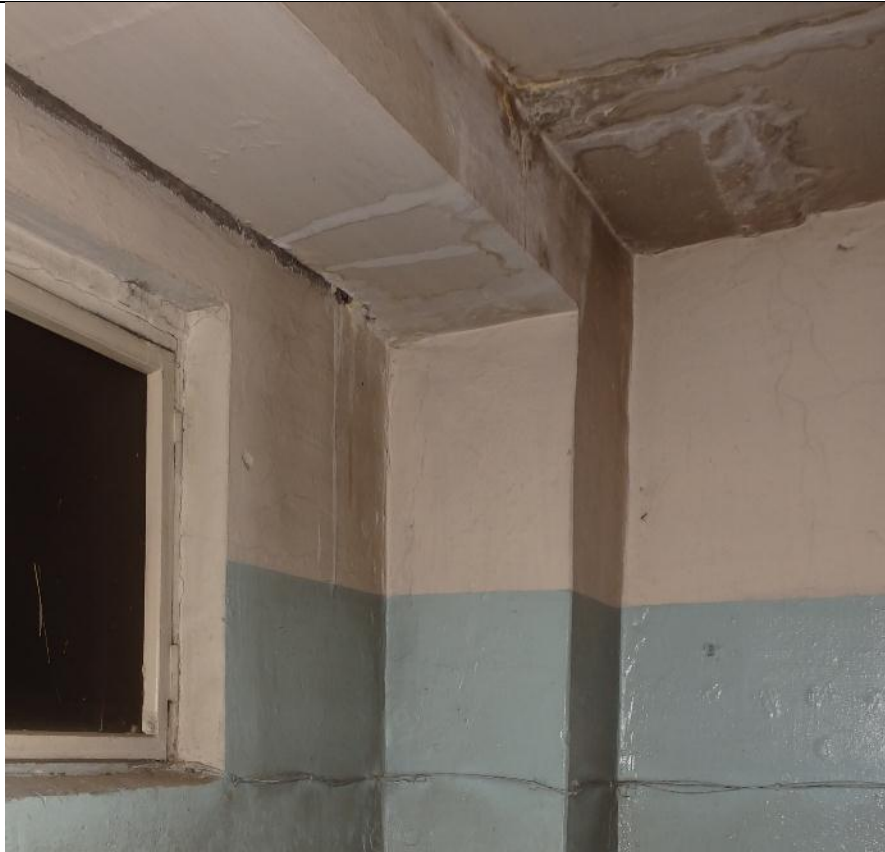
фото 26. На потолочной поверхности перекрытия помещения лифтовой в осях 6/Д отмечены следы увлажнения, отделочный слой нарушен.
