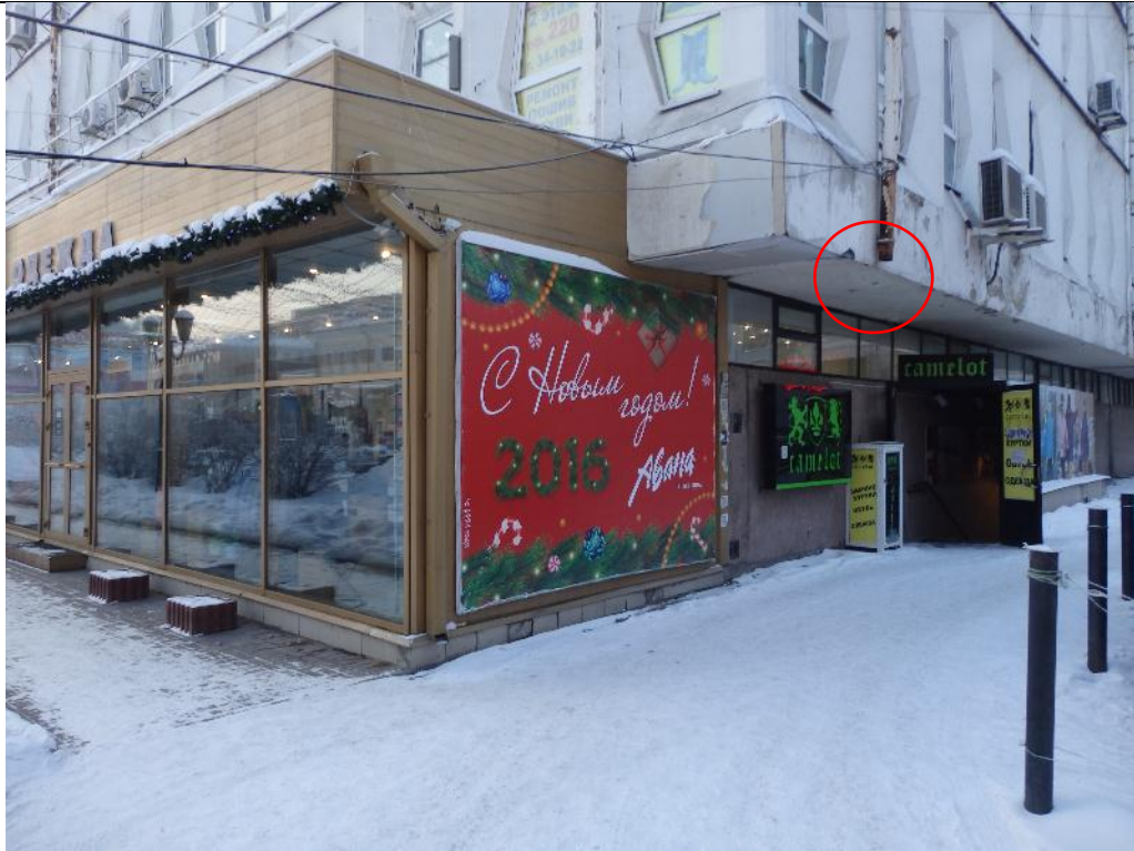
фото 15. Угол 1-го этажа здания в осях 8/А. Зафиксировано нарушение труб водосточной системы.
