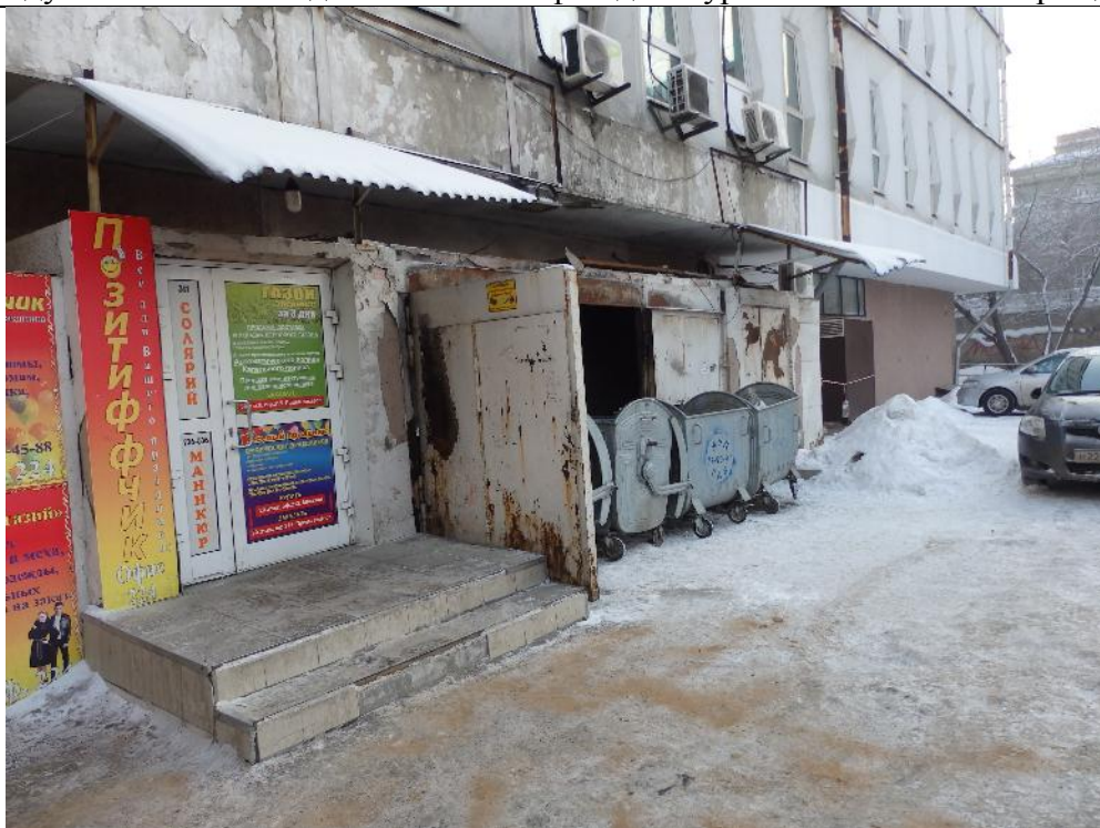
фото 8. Состояние входных групп, расположенных по фасаду в осях 6-3/Е. Отмечены сколы плитки крыльца.
