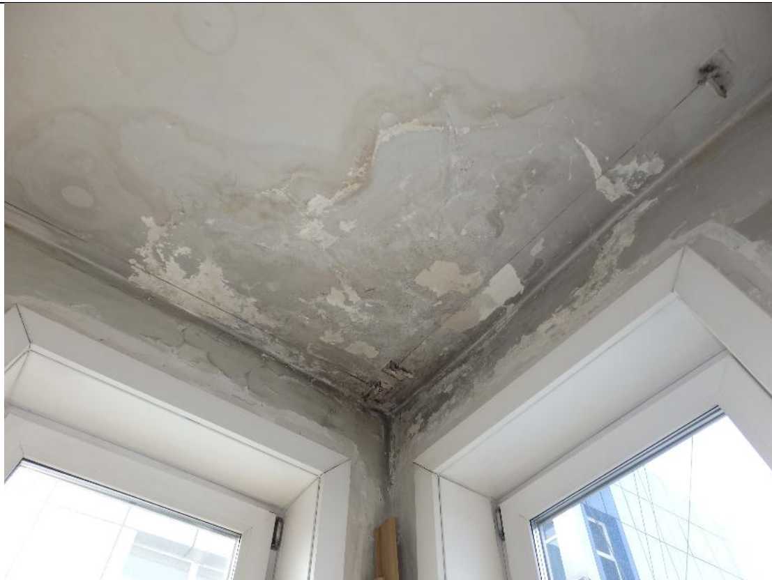
фото 39. На потолочной поверхности перекрытия 5-го этажа (монолитный участок консоли) в угловом помещении № 9 (согласно спецификации помещений) зафиксированы следы увлажнения, отделочный слой поврежден.
