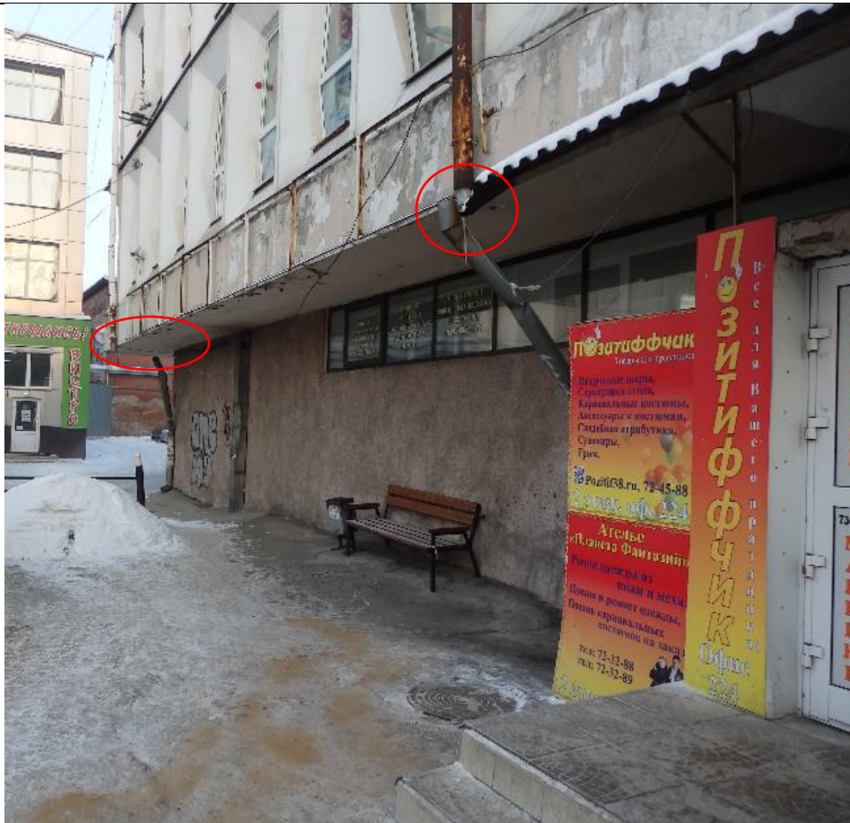
фото 7. Зафиксировано нарушение труб водосточной системы ниже уровня 2-го этажа по фасаду в осях 8-1/Е. Отделочный слой фасада на уровне 2-го этажа поврежден.
