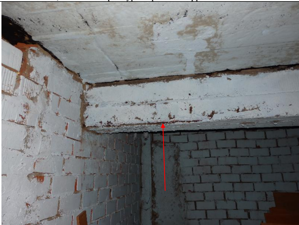
фото 60. Зафиксированы участки нарушения защитного слоя бетона балок перекрытия подвала в осях 6-7/А-Б, оголенная арматура поражена коррозией металла.
