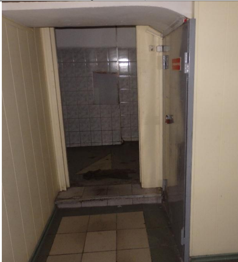
фото 54. Уровень пола лестничной клетки в осях 6-7/Д-Е ниже пола 1-го этажа на 100 мм.
