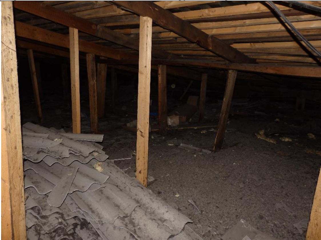
фото 22. Часть стоек стропильной системы опирается точечно на плиты перекрытия 5-го этажа, вертикальность стоек нарушена. Старый кровельный материал (шифер) лежит на перекрытии 5-го этажа.
