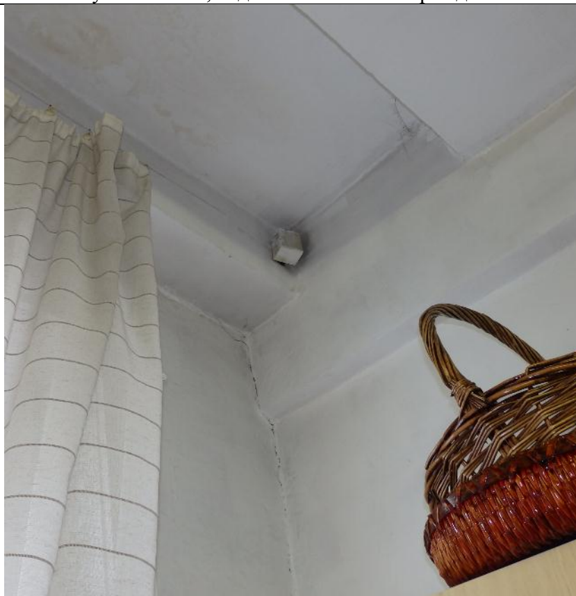
фото 40. Зафиксированы незначительные трещины в местах примыкания стеновых наружных панелей к внутренним конструкциям, шириной раскрытия до 2 мм.
